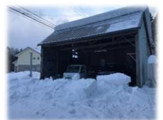
事務所屋根の落雪
